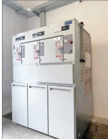
Mittelspannungsschaltanlage in der Wallgasse.
