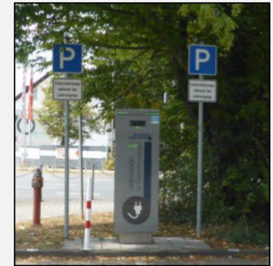
Ladesäule am Bahnhof Bild: eigene Aufnahme
